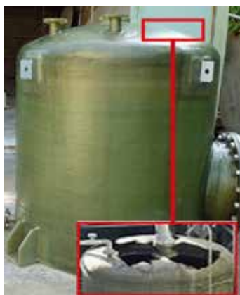
图 2: 圆柱形储罐顶部的典型倒塌。
