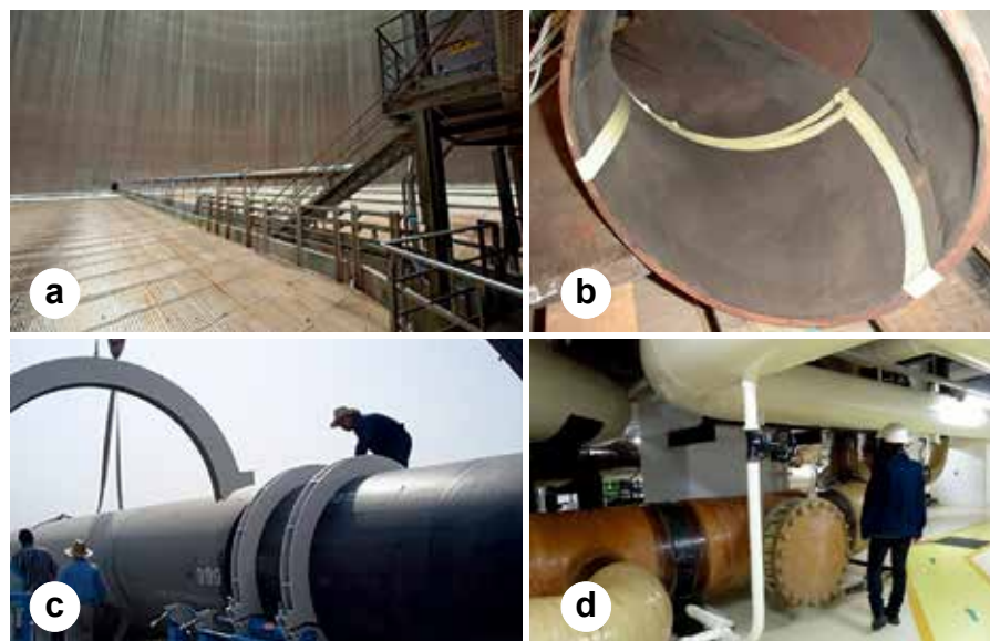
(a) EDF 冷却塔内的 PVC 冷凝系统；(b) EDF 管道系统内的氯丁橡胶衬垫；(c) HDPE 管道系统（HPC 电厂，EDF 英国）；(d) 法国 Civaux 核电站的环氧树脂复合管道系统（EDF）
