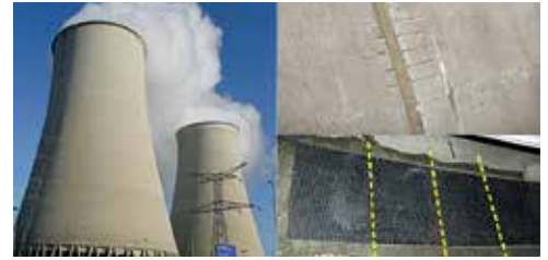
EDF 电厂 DAMPIERRE 2, Coolung 塔, 中途观察到的受损区域 - 圆形复合材料 - 环氧树脂碳板 ©
